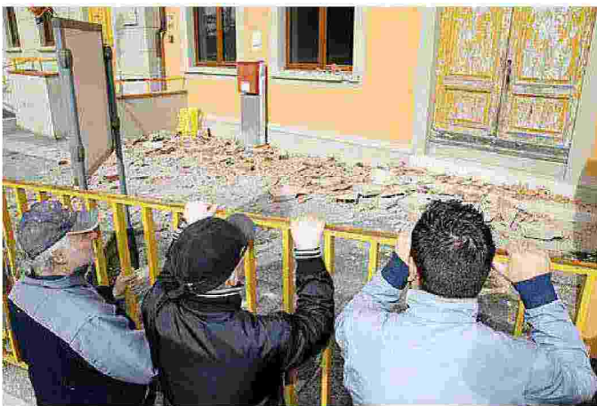
Pezzi del cornicione ancora in terra la mattina dopo il crollo (Foto Nucci)
